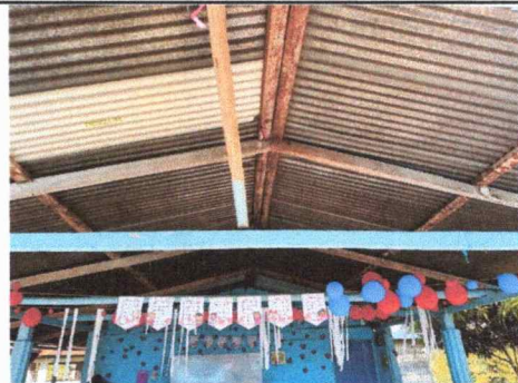
Foto 6: SE OBSERA EL DETERIORO DE LAS VIGAS DE MADERA
